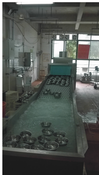
运行中的海韵学生公寓二期 餐厅洗碗机
